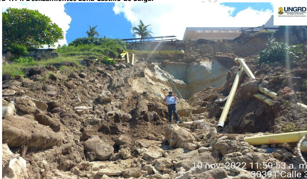
Figura 1.14. Deslizamientos zona Castillo de Salgar
